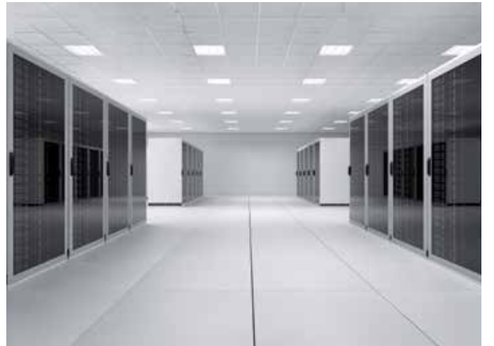
Data Centers - Centres de Traitement de Données
